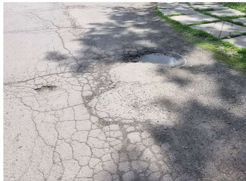
8. Поврежденное асфальтовое покрытие
